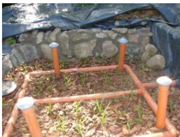
Fot. Arch. UG Sękowa – Oczyszczalnia przydomowa .
