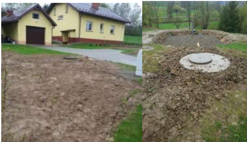
Fot. Arch. UG Sękowa – Oczyszczalnia przydomowa .
